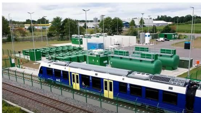
Obr. 9 Příklad plnicí vodíkové stanice včetně infrastruktury
