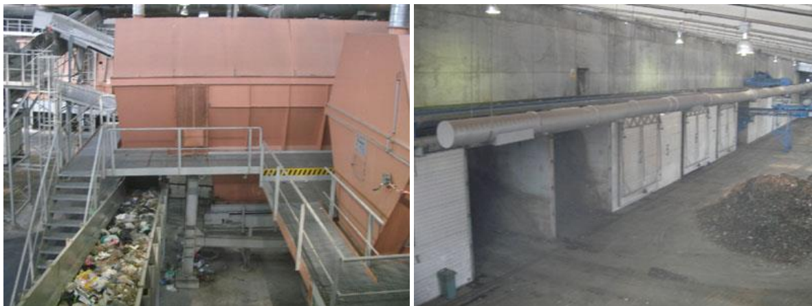
Obr. 59 Doprava do rotačního síta (vlevo) a tunel pro SKO (vpravo)
