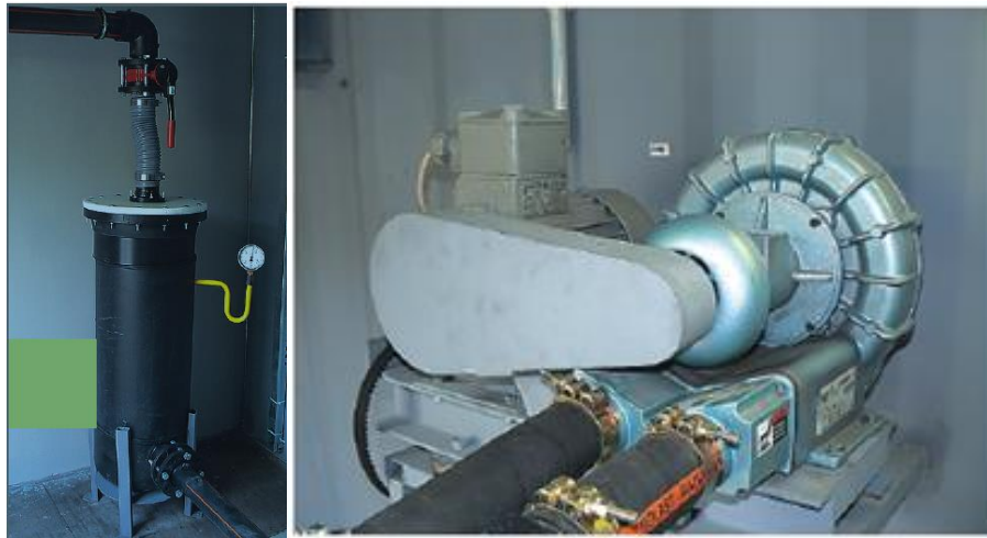
Obr. 50 Odlučovač vlhkosti z plynu a dmychadlo
