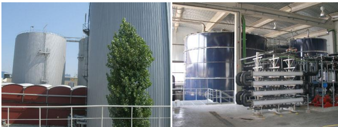
Obr. 60 Anaerobní digester (vlevo) a ČOV s biologickým stupněm (vpravo)
