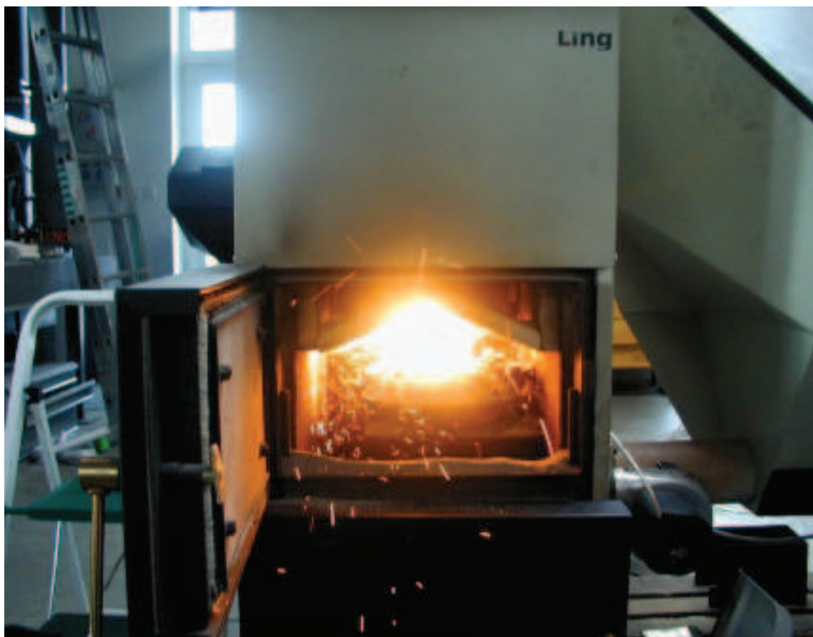
OBR. Č. 22 KOTEL LING 25 PŘI SPALOVACÍ ZKOUŠCE
