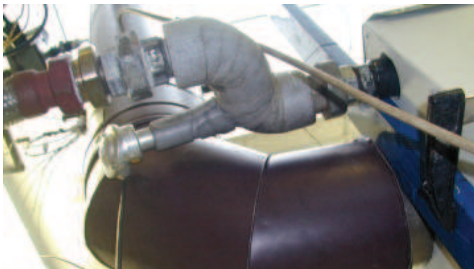
OBR. Č. 10 UMÍSTĚNÍ TEPLOTNÍHO ČIDLA PRO MĚŘENÍ TEPLoty KOTLOVÉ VODY
