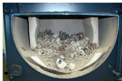
obr. č. 20 Popel ve spodní části kotle
