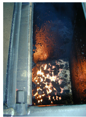
obr. č. 16 Pohled na hořící palivo do zásobníku kotle
