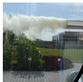
obr. č. 12 Kouř vycházející z kotle při části zkoušky 3-1
