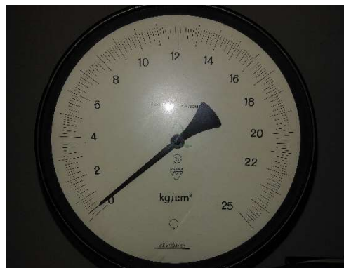
Obrázek 10 Manometr k měření statického tlaku na cloně
