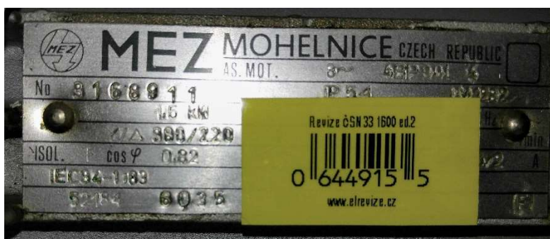
Obrázek 2 Detailní fotografie a štítky kompresorové jednotky s pístovým kompresorem 2 JVK 50
