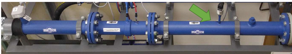
Obrázek 7 Měřící trať s kuželovým průtokoměrem DN80 PN16 s umístěním snímače měření absolutního tlaku na sání
