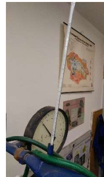
Obrázek 9 Rtuťový teploměr umístěný v teploměrové jímce
