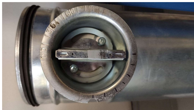
Obrázek 11 Plně otevřená regulační klapka na výtlačném potrubí axiálního ventilátoru s označením regulačních poloh
