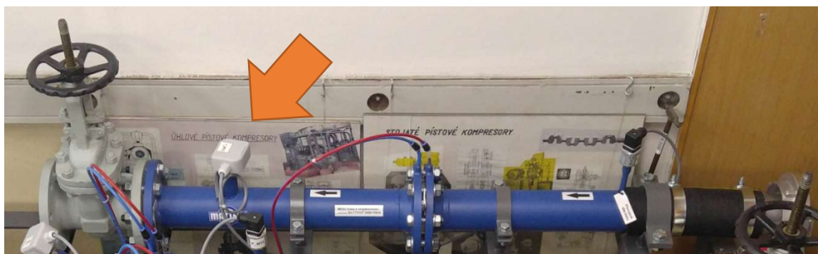
Obrázek 11 MT3 Měřicí trať s víceotvorovou clonou DN80 PN16 a výstupním plnopřůtočným šoupětem s umístěním snímače měření teploty na výtlaku
