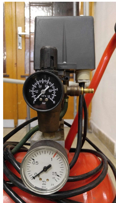
Obrázek 4 Analogový manometr připojený na výtlakové potrubí měřeného pístového kompresoru i s výstupním filtrem regulátorem a koncovkou pro připojení tlakové hadice
