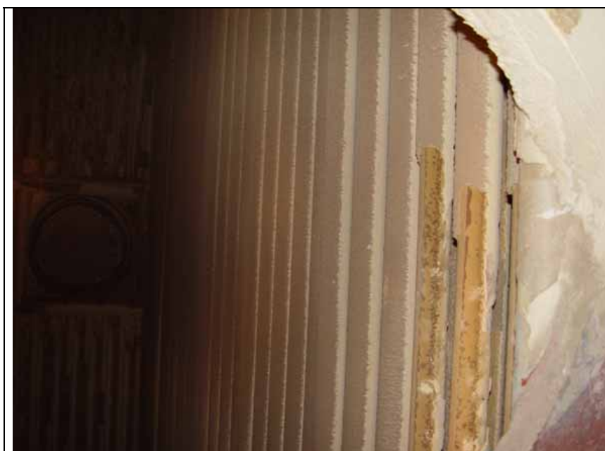
Obr. 5.68. Příklady koroze výhřevných ploch na straně spalin
