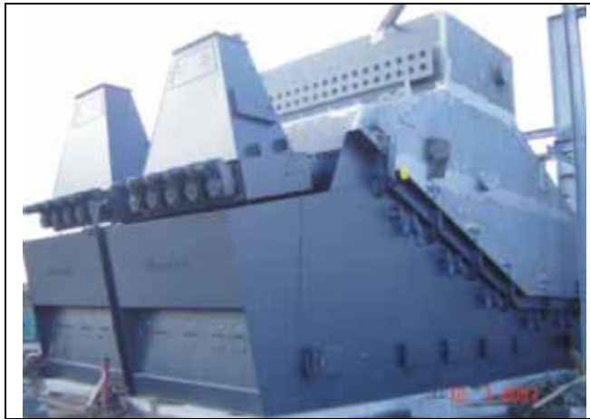
Obr. 5.38. Šnekové podavače paliva pro velkou spalovací komoru
