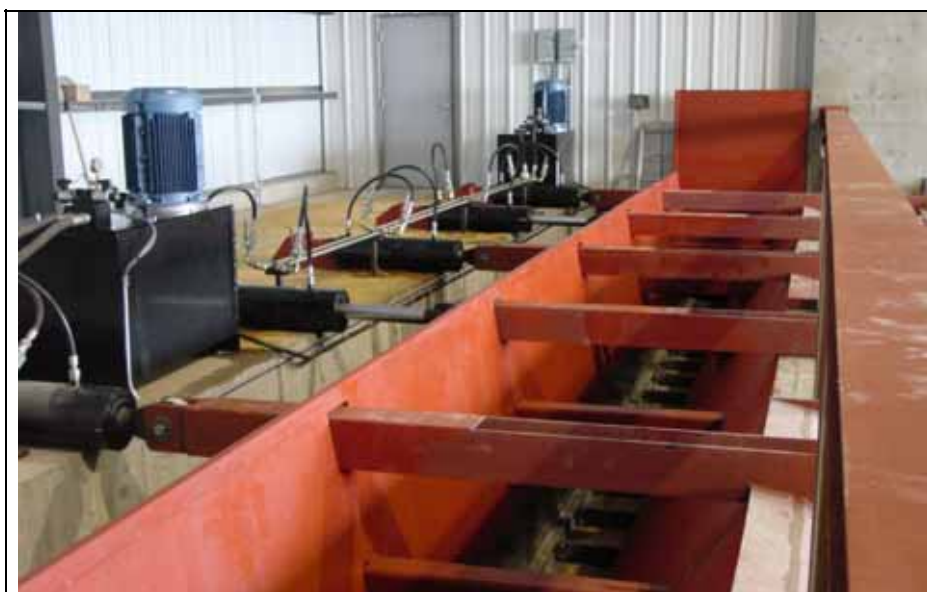
Obr. 5.21. Pohon vyhrnovací podlahy a výstup do koryta s dopravníkem
