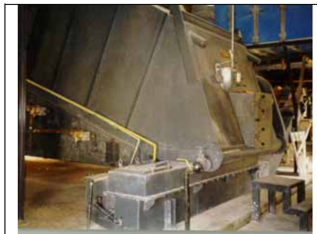
Obr. 5.44. Umístění odškvárovacího redleru na topeništi
