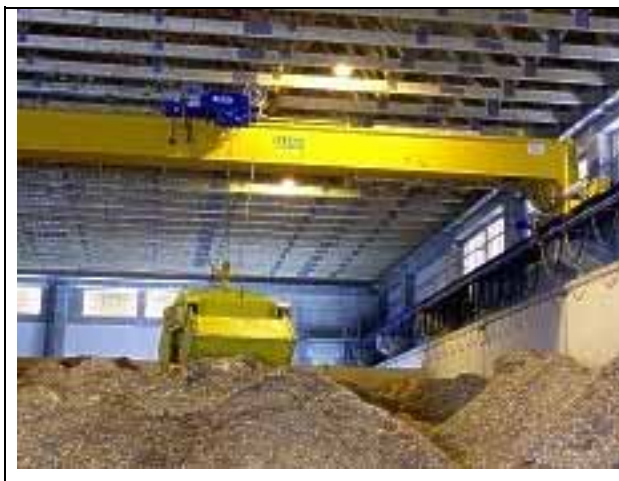
Obr. 5.30. Automatický jeřáb pro manipulaci s palivem v kotelně na spalování biomasy v Bystřici nad Pernštejnem
