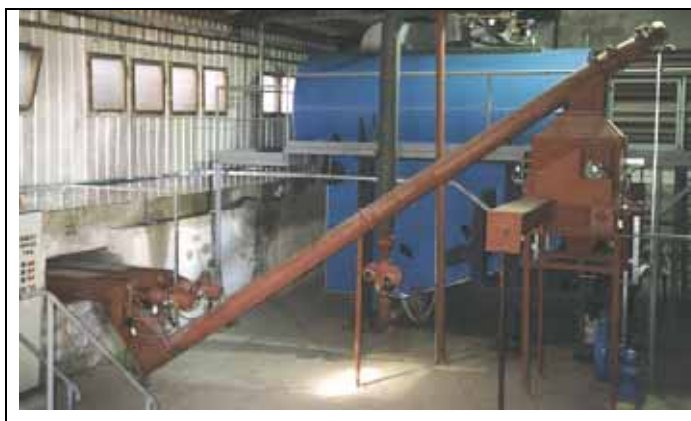
Obr. 5.13. Sestava šnekových dopravníků, vpravo je vidět výstup šnekového dopravníku ze zásobníku, zatím slepého, ale dodatečně byla instalována druhá kotlová jednotka
